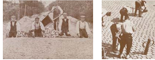
Bau einer Kleinpflaster- sowie einer Großpflasterdecke in den 1920er Jahren [Quelle: Kühn 1974]
